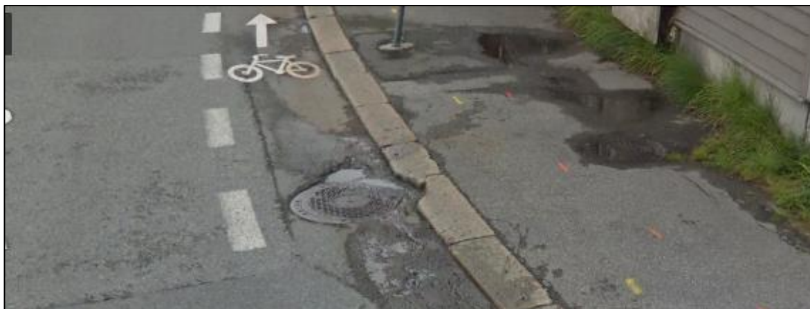
Figur 53 Manglende vedlikehold i sykkelfeltet ved Vågsgaten. (Kilde: Google Maps)
