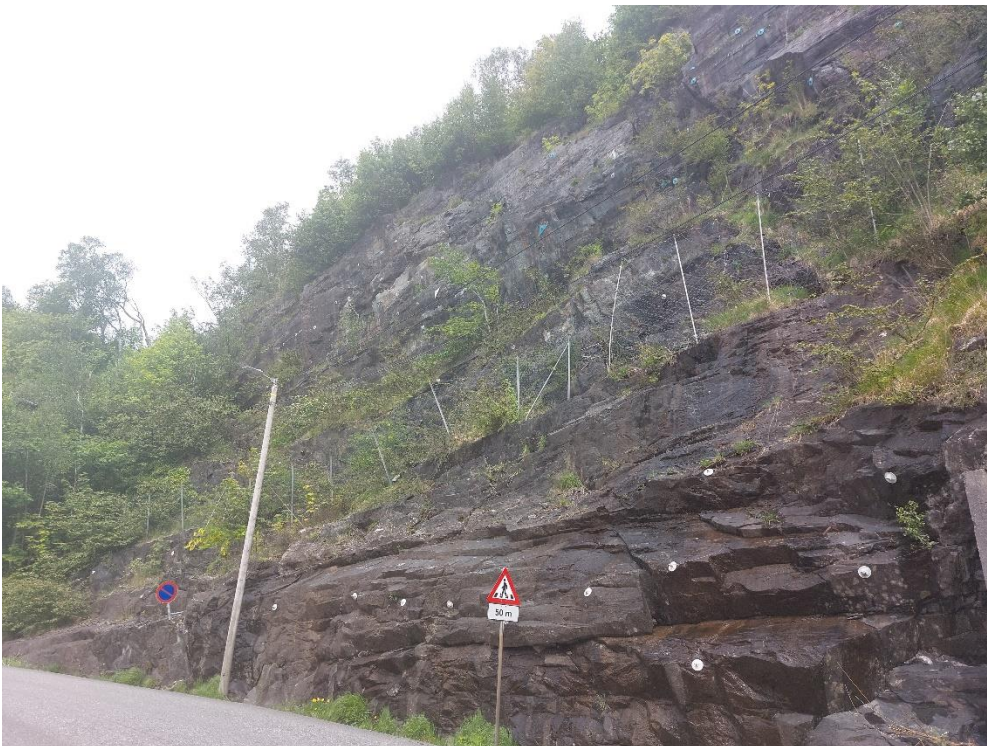
Figur 21: Nordlige delen av vegstrekningen med bolting og fanggjerde.
