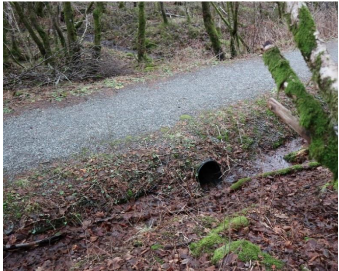
Figur 11: Overvann/flomvann fra planområdet renner under turvei via rør og mot bekk på østsiden av turveien, utenfor planområdet. Foto 2018: Opus.
