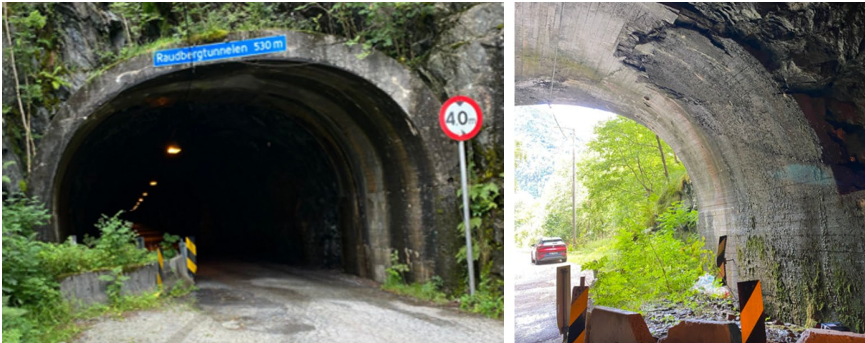
Figur 11-23 Raudberg tunnelen, søndre portal. Denne er skadet, og må utbedres.
